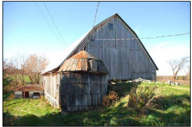
172. Un silo de bois construit à l'origine sur un autre site agricole a été déplacé à l'avant de la grange-étable située au 1215, chemin Perreault, Compton (COM-005).
