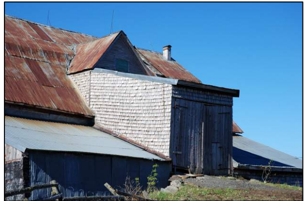
136. Garnaud ajouté ultérieurement à la grange-étable, se caractérisant par sa toiture en appentis, son recouvrement en bardeaux de cèdre et sa porte à deux battants, situé au 610, route 253, Saint-Venant-de-Paquette (STV-001).
