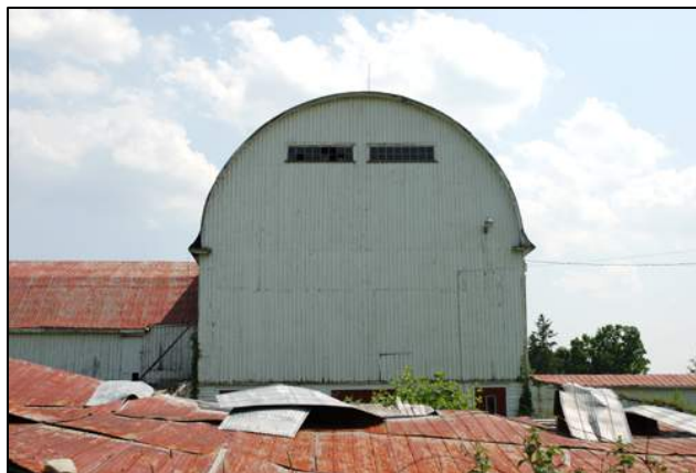
59. Façade latérale gauche de la grange-étable à toit arrondi visible au 320, route 147, Dixville (DIX-005).
