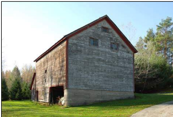
159. Grange-étable située au 4045, route 147, Waterville (WAT-003).
