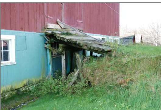
Pont d'accès en mauvais état et monticule affaissé.
