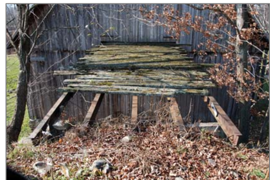
Pont d'accès en ruines qui n'est plus du tout sécuritaire.
